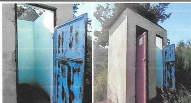
Foto 2: Servicios sanitarios colapsados,
