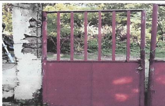
Foto 4: Área de ingreso completamente dañada.
